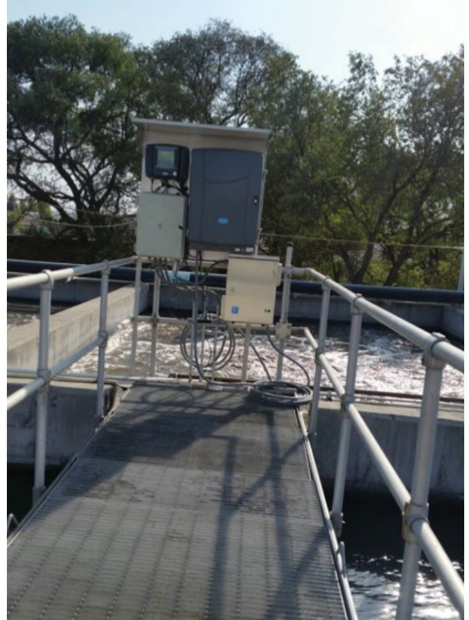
Fig. 7. Sistema RTC-P instalado y en funcionamiento
