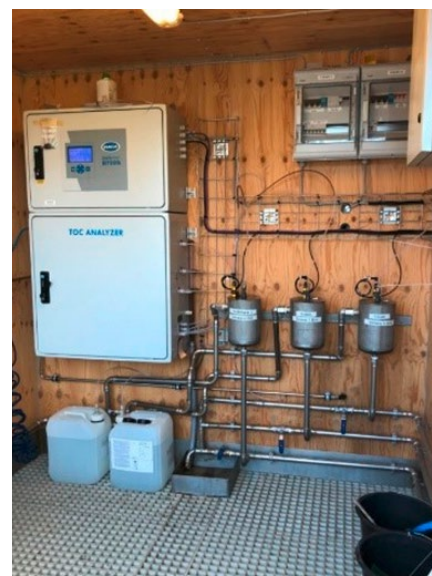
Figura 1: medición de TOC en continuo con el analizador BioTector de Hach en la línea de suministro de la planta de tratamiento.
